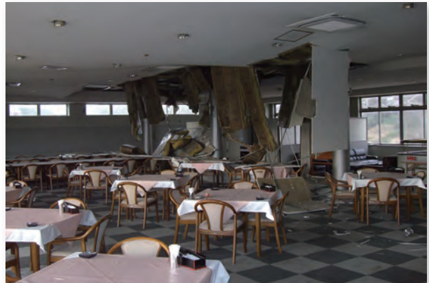
▲南岩手CCはレストランの天井が崩壊
