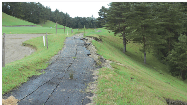
太白CC(旧秋保CC)18番ホールの右斜面が崩落。1番ホールのフェアウェイまで土砂が流れた
